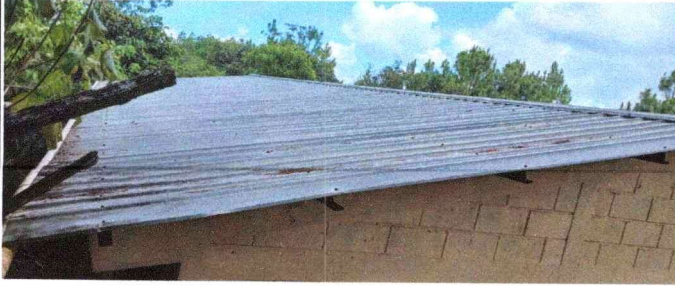
FOTO No. 1: Vista de techo de modulo 1 en mal estado.
